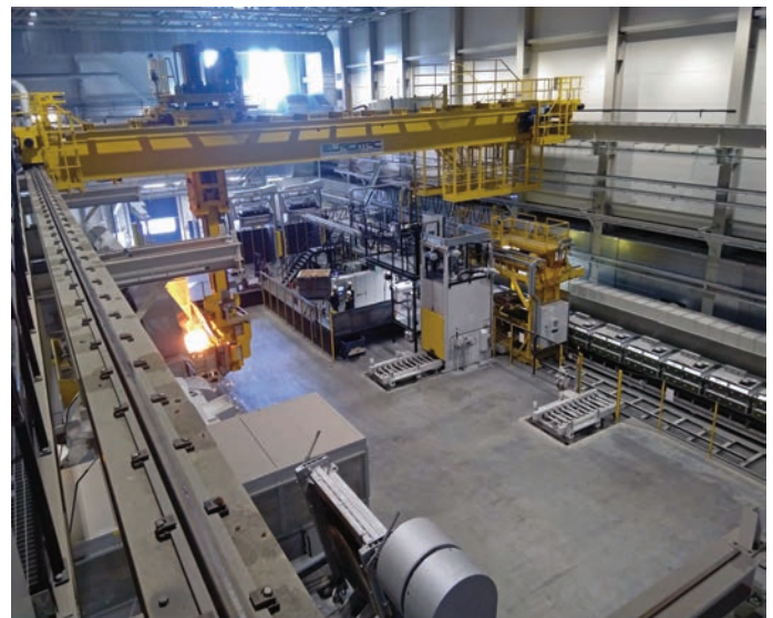
Vista general del departamento de fusión en la nueva fundición
